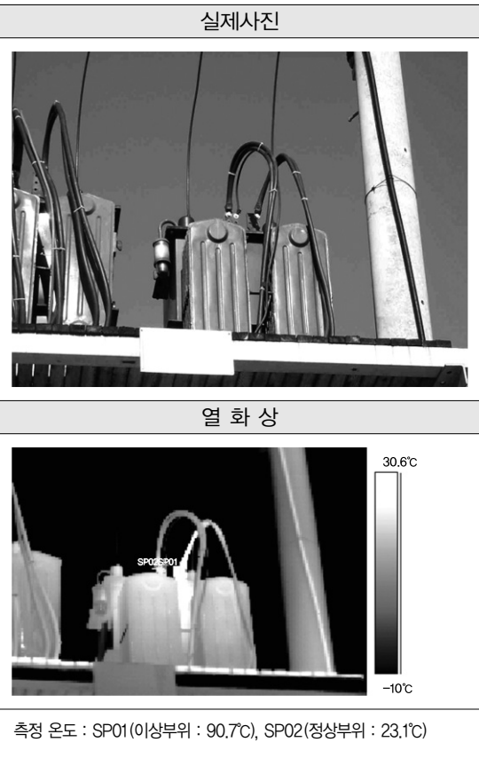
[진단사례 ①] 2차측 케이블 단말부의 Bolting 불량에 의한 이상 발열
